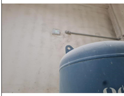
6.7 - FOTO DA LUMINÁRIA DE EMERGÊNCIA
