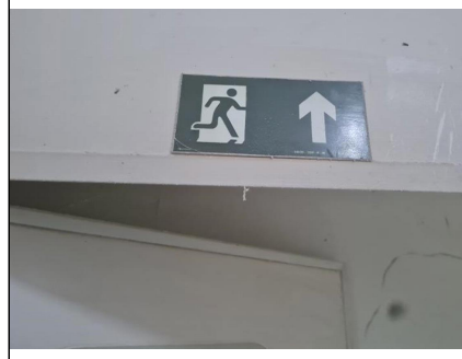
6.10 - FOTO DA PLAQUETA DA SAÍDA DE EMERGÊNCIA
