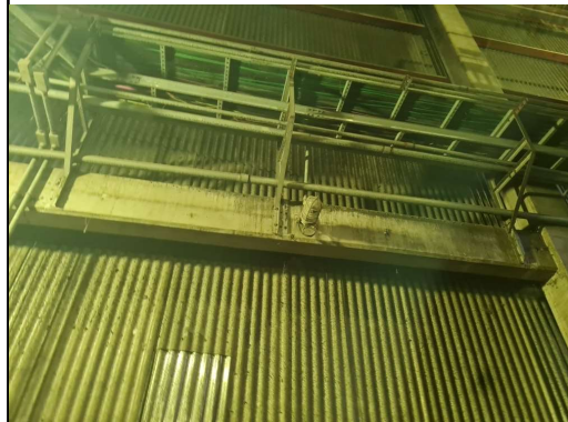
6.8 - FOTO DA LUMINÁRIA DE EMERGÊNCIA
