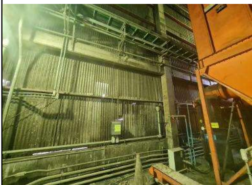
6.9 - FOTO DO SISTEMA DE VENTILAÇÃO
