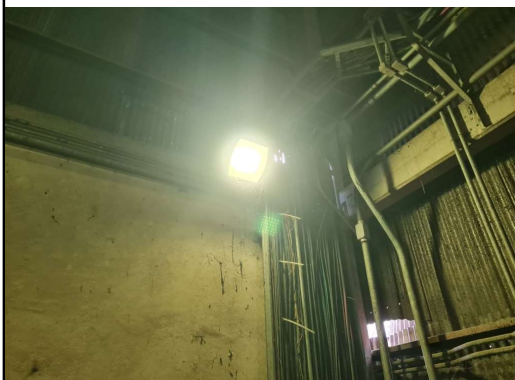
6.7 - FOTO DA ILUMINAÇÃO
