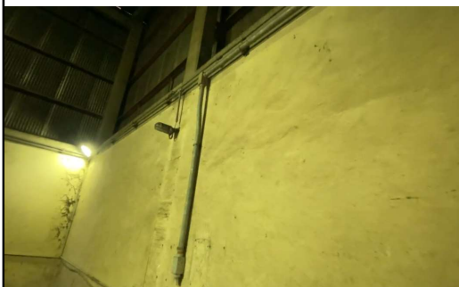
6.5 - FOTO DO AMBIENTE DE INSTALAÇÃO (LATERAL LADO - VALONGO)
