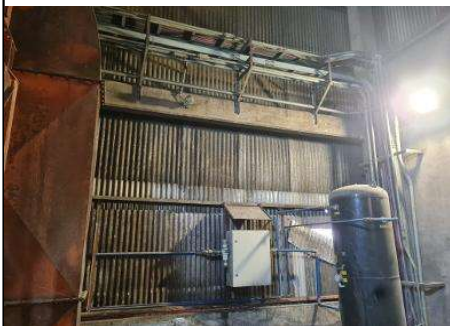
6.9 - FOTO DO SISTEMA DE VENTILAÇÃO
