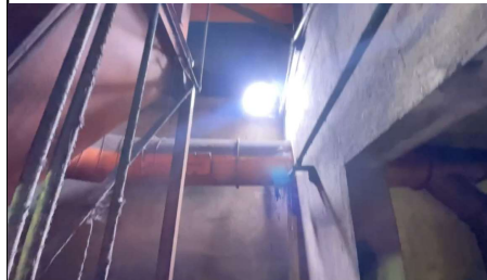
6.4 - FOTO DO AMBIENTE DE INSTALAÇÃO (LATERAL LADO - CENTRO)
