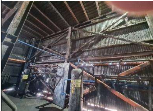
6.9 - FOTO DO SISTEMA DE VENTILAÇÃO
