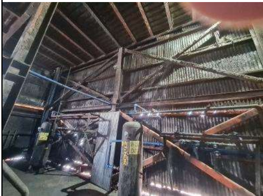
6.9 - FOTO DO SISTEMA DE VENTILAÇÃO
