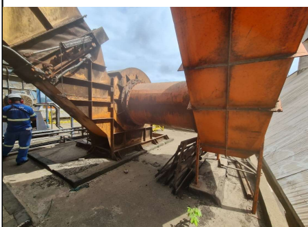
6.5 - FOTO DO AMBIENTE DE INSTALAÇÃO (LATERAL LADO - VALONGO)
