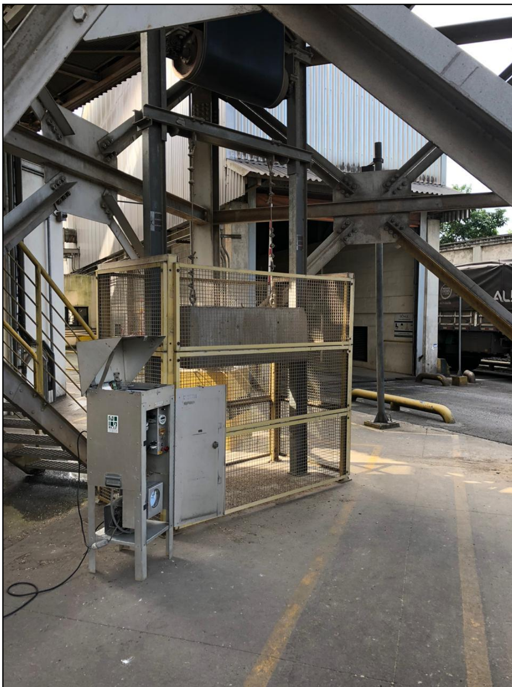
Equipamento Instalado no Pátio Externo 3
