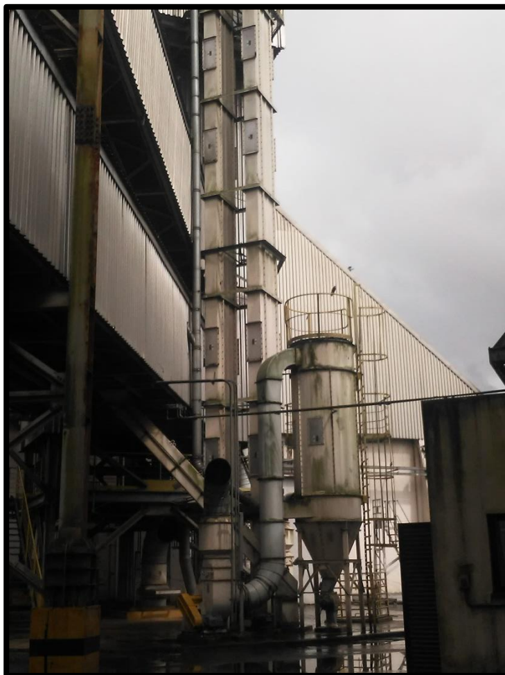
Figura 21: Vista de um dos filtros manga existente no empreendimento.
