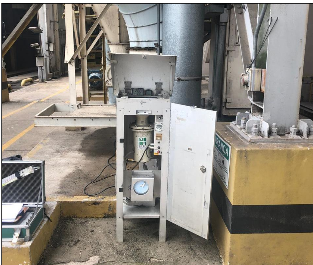
Equipamento Instalado no Pátio Externo 2
