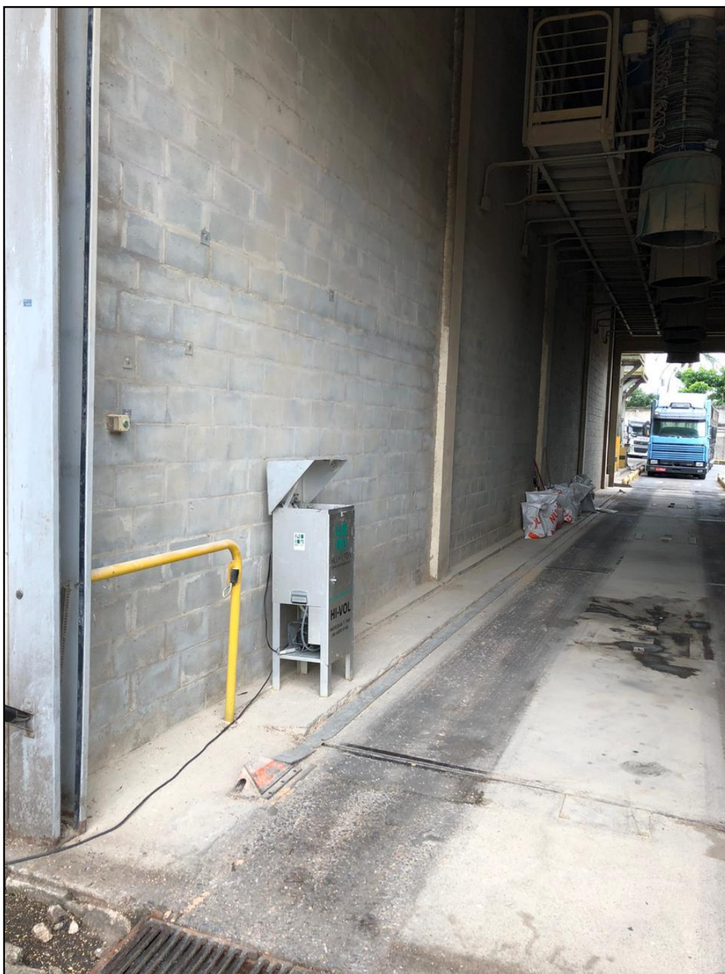
Equipamento Instalado dentro da Balança de Carregamento de Grãos
