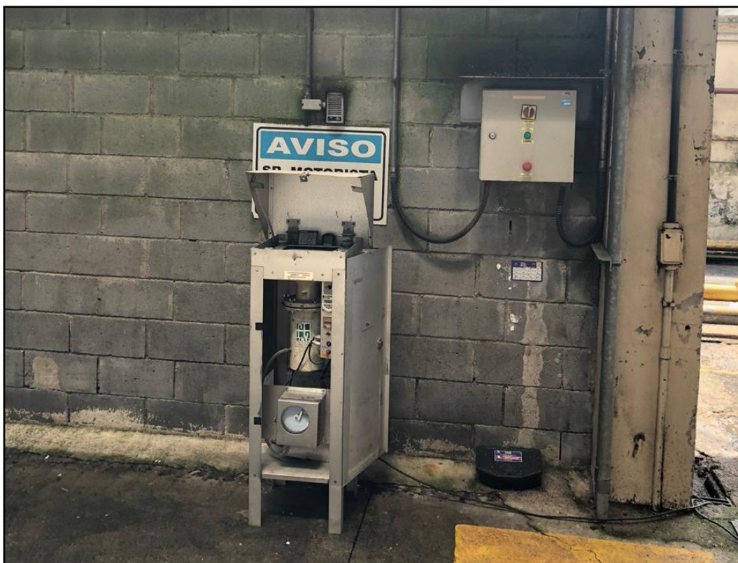
Equipamento Instalado no Pátio Externo 1
